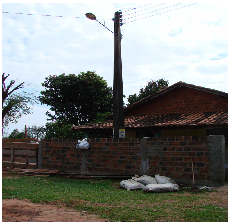
FIGURA 30: PROBLEMA DE LOCAÇÃO
