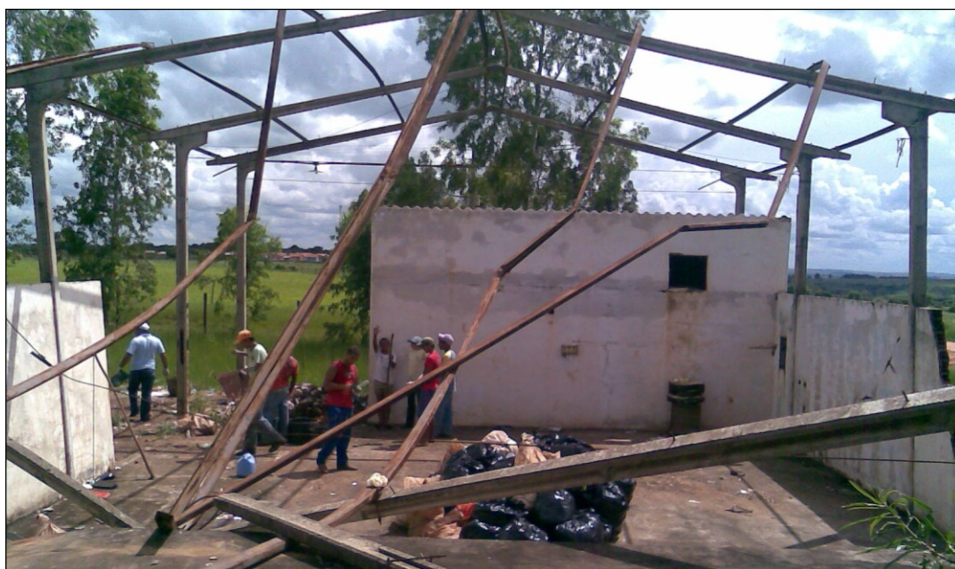
Figura 03 – Vista parcial da área de recebimento de recicláveis – jan/2010 Organização: Caxangá Planejamento Agropecuário Ltda
